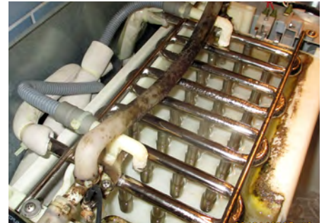
Biofilm im Innenbereich einer Eiswürfelmaschine.
