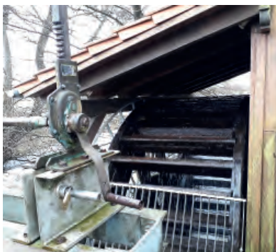
Wahrenholz: Mit Wasserkraft Strom für die Straßenbeleuchtung erzeugen
